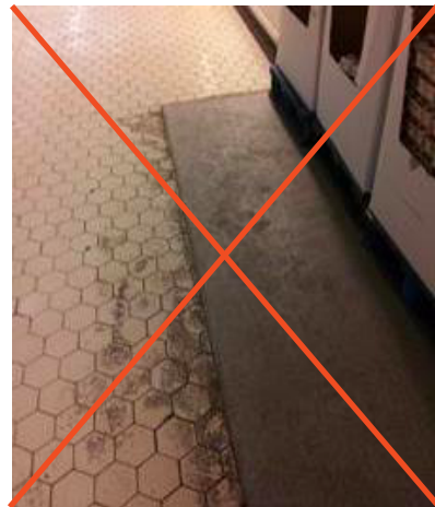
Nicht geeigneter Bodenbelag.
